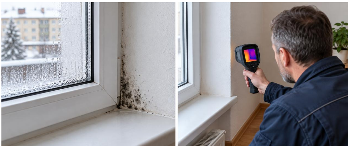
Obr. 1 Kondenzace a porost u okna vlevo, stavební diagnostika vpravo. Ilustrační obrázky.
